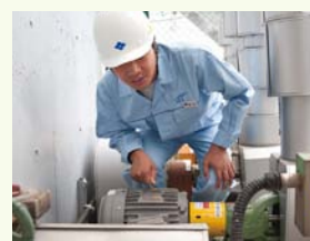
排水処理場のポンプを ECOポンプに置き換え
