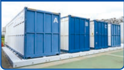
レドックスフロー電池
